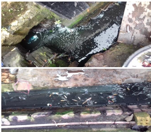
Gambar 3. Kondisi selokan/parit pada kawasan perumahan di Kecamatan Tuan Kentang
